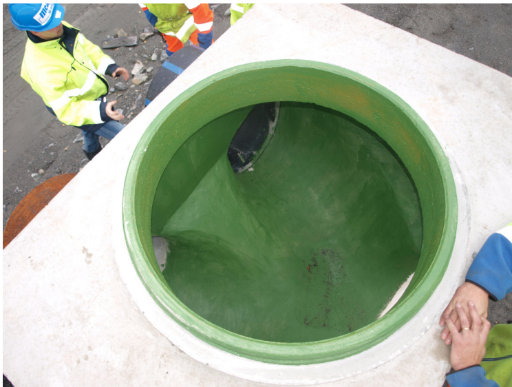
Bild: RV 155 Göteborg, inloppsbrunn ALFA SVR Elementbrunn
