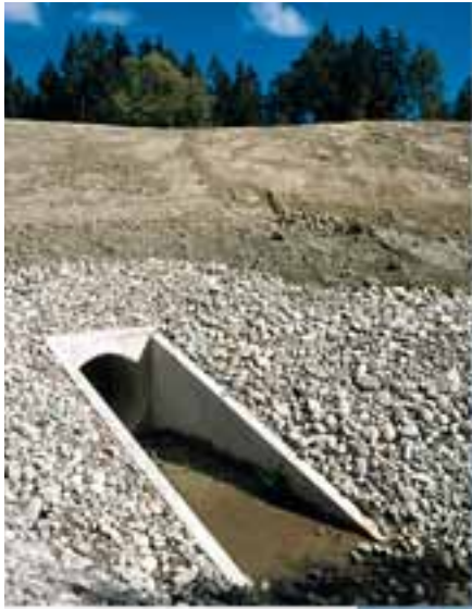
Här visas exempel på vägtrummor av betong som lagts vid byggnad av den nya Sunningeleden utanför Uddevalla. Trumögona, som kan förses med galler, är anpassade till Vägverkets trafiksäkerhetsplan för vägens sidoområde.
